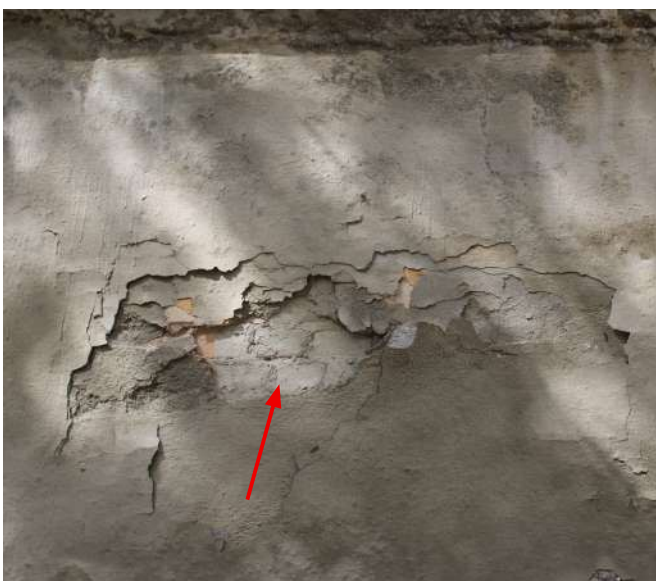
fig 29. Obturação errônea com argamassa à base de cimento realizado em trecho da face externa do Muro. Data: 22/05/2023.
