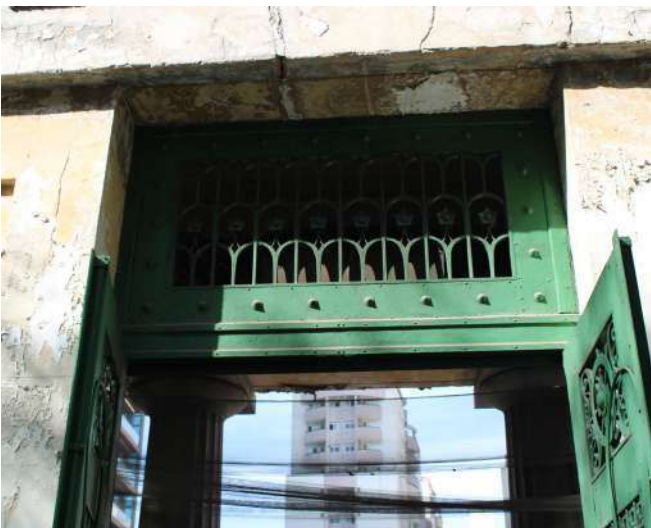
fig 81. Detalhe da bandeira do portão de ferro localizado na Fachada Posterior do Pórtico Frontal. Data: 22/05/2023.
