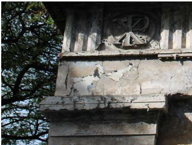
fig 21. Desprendimento das camadas de pintura no Pórtico Frontal. Data: 22/05/2023.
