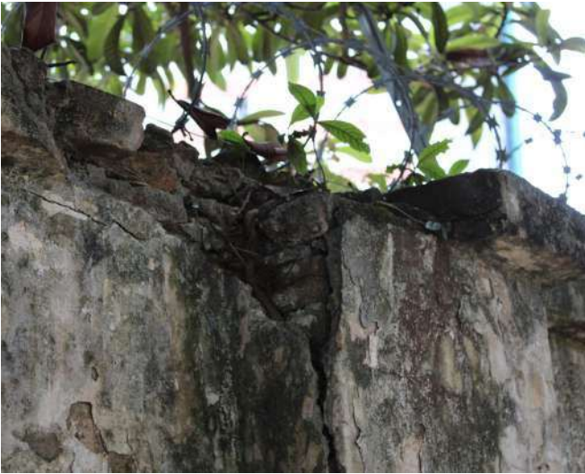
fig 251. Exemplo de vegetação infestante de menor porte já provocando o desprendimento de argamassa. Data: 22/05/2023.
