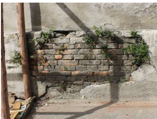
fig 17. Desprendimento de argamassa em trecho do sóculo da face externa do Muro. Data: 22/05/2023.
