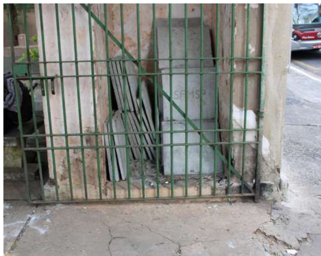
fig 156. Faces internas das colunas que estruturam o Pórtico Posterior, com destaque para os materiais depositados inadequadamente. Data: 22/05/2023.
