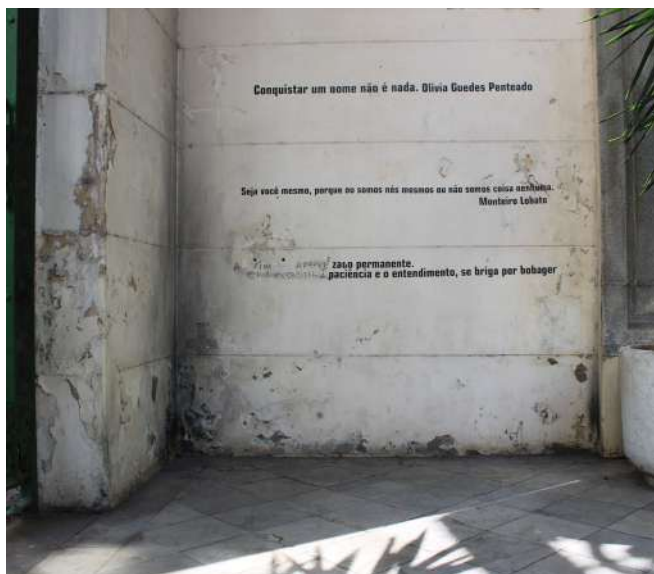
fig 34. Presença de umidade ascendente nas faces internas do Pórtico Frontal. Data: 22/05/2023.
