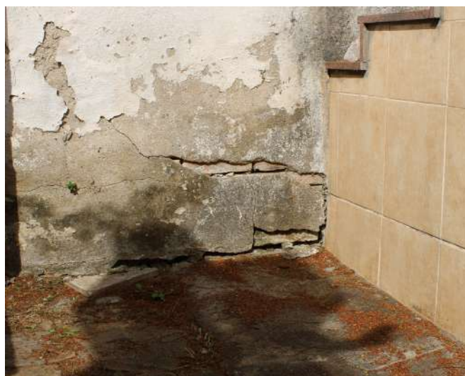
fig 256. Ação da umidade ascendente provocando o desprendimento das camadas de pintura e da argamassa da base. Data: 22/05/2023.
