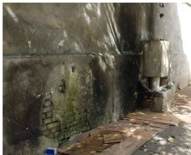
fig 224. Além da ação da umidade ascendente, nota-se nesse trecho, as consequências da ação antrópica: fuligem ocasionada por queimas. Data: 22/05/2023.
