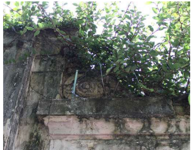
fig 266. Exemplo de um dos ornamentos em voluta, componentes dos muros, completamente tomado por vegetações infestantes. Data: 22/05/2023.
