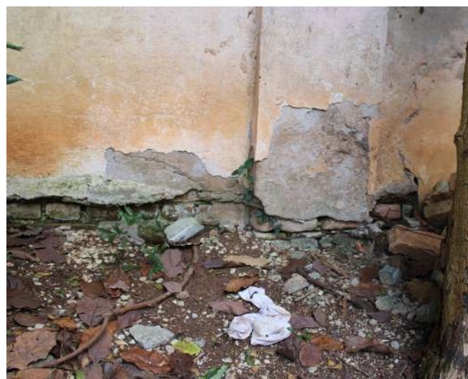
fig 244. Ação da umidade ascendente provocando o desprendimento das camadas de pintura e da argamassa da base. Data: 22/05/2023.
