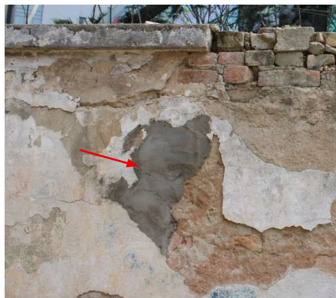
fig 30. Obturação errônea com argamassa à base de cimento realizado em trecho da face interna do Muro. Data: 22/05/2023.
