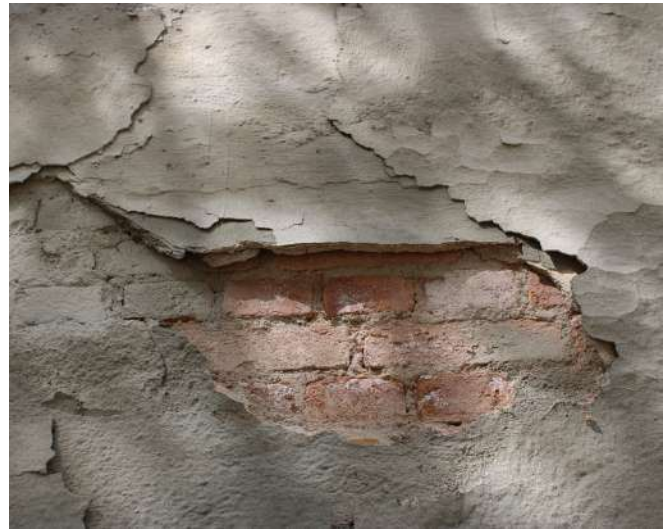
fig 222. Trecho com desprendimento de argamassa e consequente exposição dos tijolos. Data: 22/05/2023.
