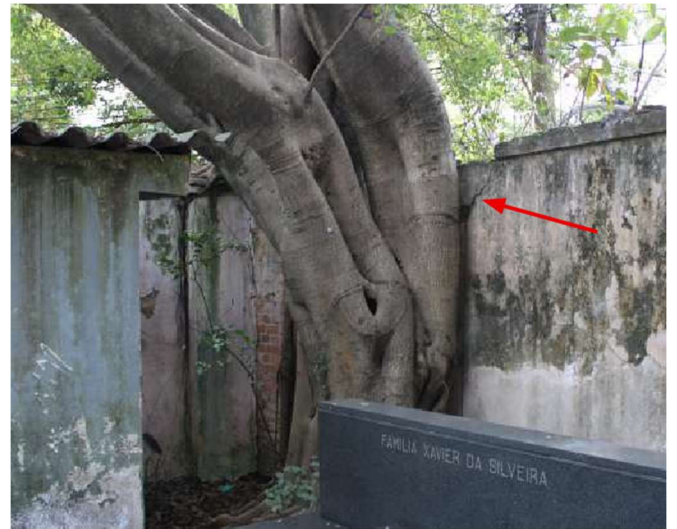
fig 254. Conjunto de trincas e trecho de argamassa já deslocado ocasionados pela árvore de grande porte encontrada junto ao muro. Data: 22/05/2023.
