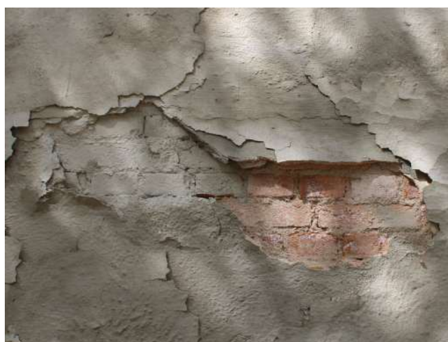
fig 18. Desprendimento de argamassa em trecho da face externa do Muro. Data: 22/05/2023.
