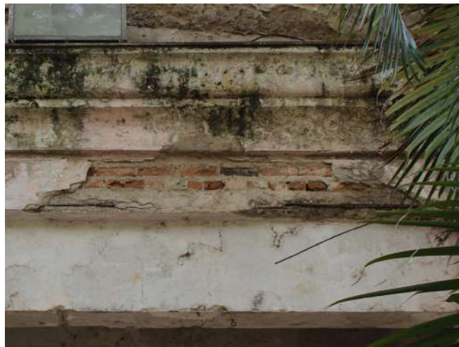
fig 16. Desprendimento de argamassa em trecho do entablamento do Pórtico Posterior. Data: 22/05/2023.
