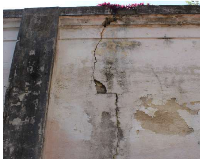
fig 264. Grande trinca vertical possivelmente provocada pela presença de vegetação infestante. Data: 22/05/2023.
