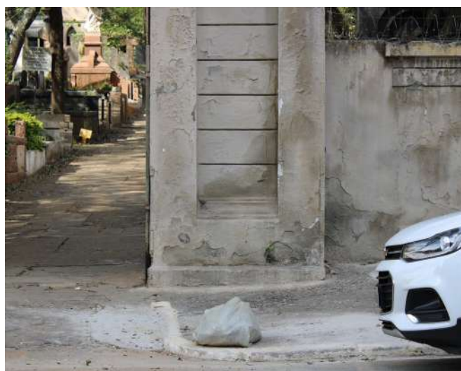
fig 131. Detalhe do trecho inferior da coluna direita do Pórtico Posterior, Vista Frontal. Data: 22/05/2023.
