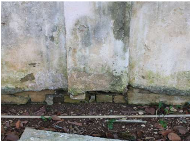
fig 9. Colonização biológica encontrada em trecho da face interna do Muro. Data: 22/05/2023.
