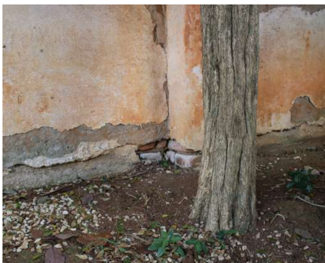
fig 243. Ação da umidade ascendente provocando o desprendimento das camadas de pintura e da argamassa da base. Data: 22/05/2023.
