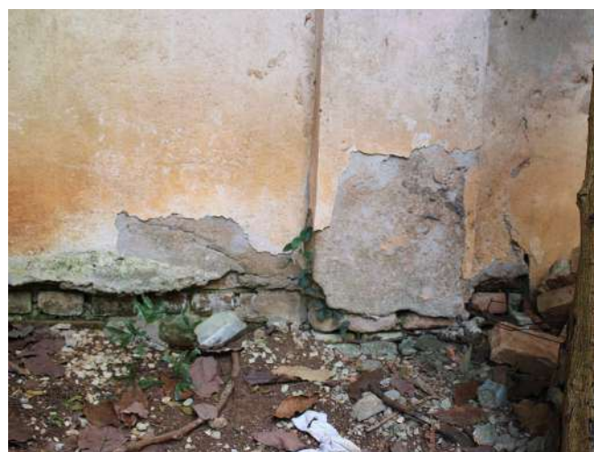
fig 26. Trecho com desprendimento das camadas de pintura na face interna do Muro. Data: 22/05/2023.
