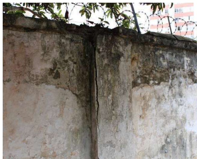
fig 250. Trinca vertical indicando o contínuo deslocamento da argamassa. Data: 22/05/2023.
