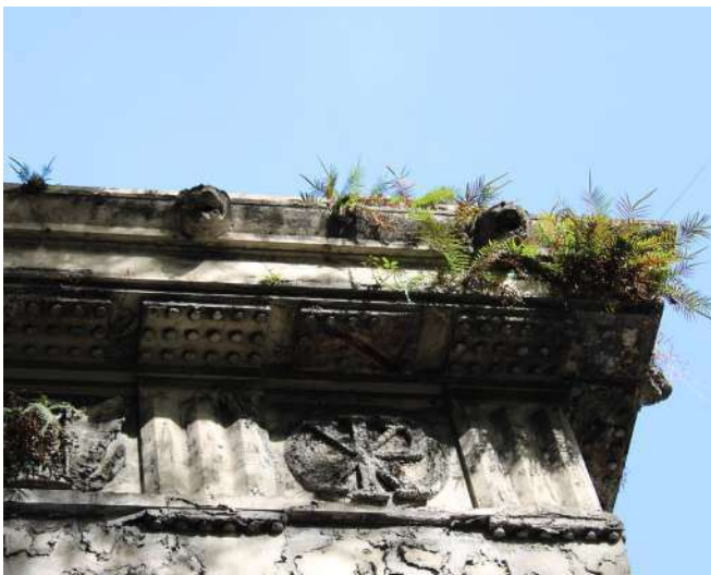
fig 71. Detalhes das gárgulas e réguas com gotas. Pórtico Frontal, Vista Lateral Direita. Data: 22/05/2023.
