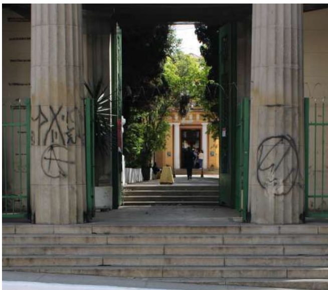
fig 31. Pichações nos fustes das colunas do Pórtico Frontal. Data: 22/05/2023.
