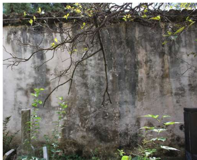
fig 260. Grandes manchas de coloração escura indicando a presença de umidade e colonizações biológicas. Data: 22/05/2023.
