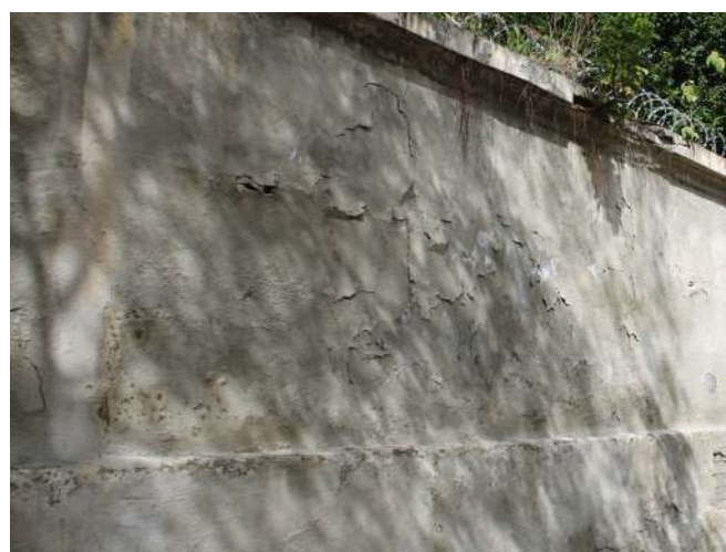
fig 24. Trecho com desprendimento das camadas de pintura na face externa do Muro. Data: 22/05/2023.
