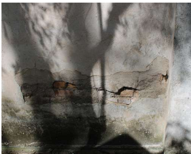
fig 269. Ação da umidade ascendente provocando o desprendimento das camadas de pintura e da argamassa. Data: 22/05/2023.
