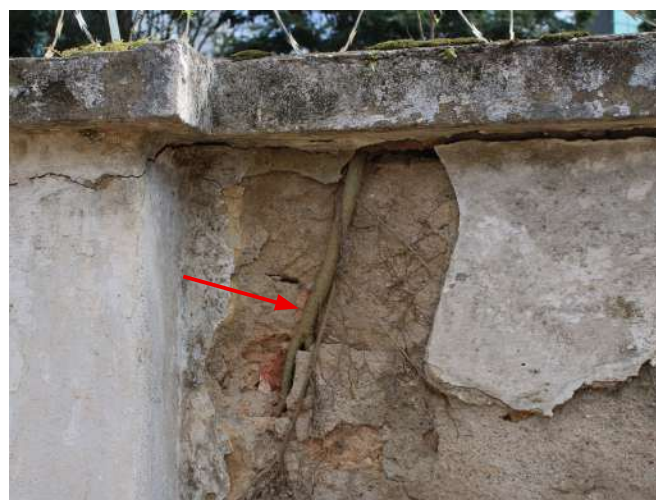
fig 38. Raízes encontradas em trecho da face interna do Muro. Data: 22/05/2023.
