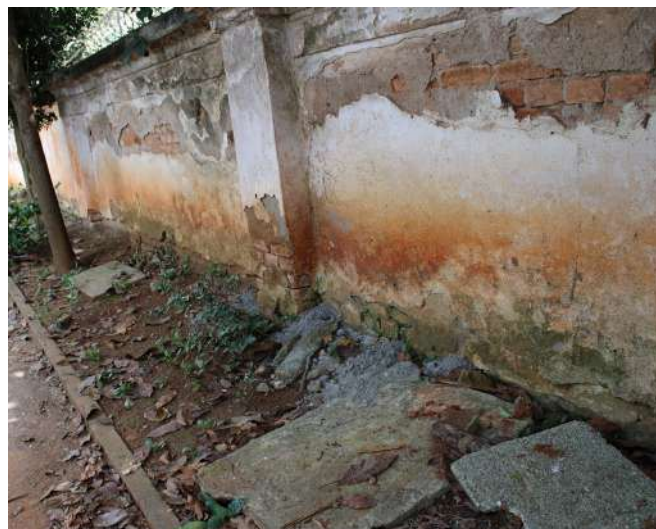
fig 174. Trecho da face interna do Muro voltado para a Rua Mato Grosso. Data: 22/05/2023.
