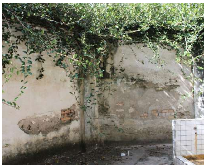
fig 268. Ação da umidade provocando o desprendimento das camadas de pintura e da argamassa. Notam-se também as vegetações infestantes. Data: 22/05/2023.
