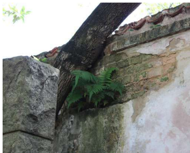
fig 262. Exemplo de vegetação infestante de menor porte já provocando o desprendimento de argamassa. Data: 22/05/2023.
