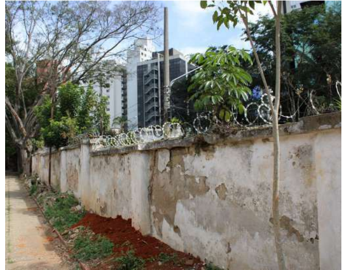
fig 170. Trecho da face interna do Muro voltado para a Rua Mato Grosso. Data: 22/05/2023.
