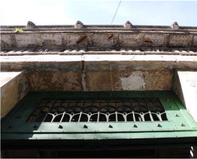
fig 122. Trecho acima da bandeira do portão de ferro onde é possível observar a argamassa. Data: 22/05/2023.
