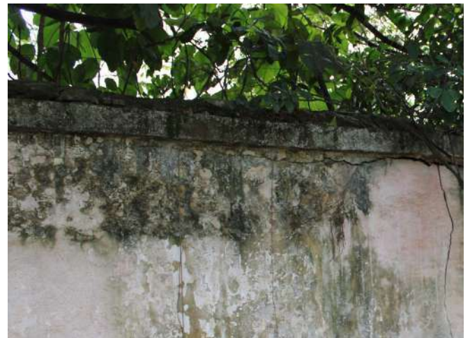
fig 10. Colonização biológica encontrada em trecho da face interna do Muro. Data: 22/05/2023.
