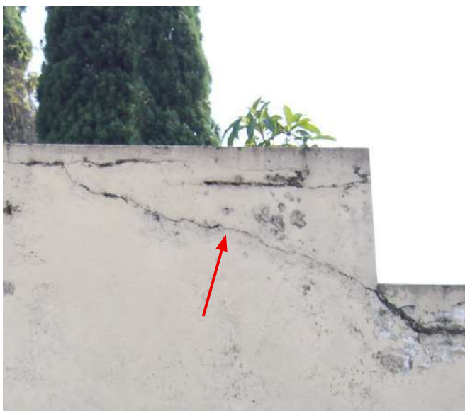
fig 27. Fissura encontrada na face frontal do Pórtico Frontal. Data: 22/05/2023.
