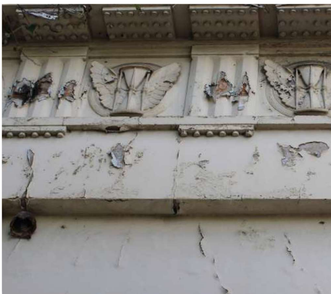
fig 33. Presença de umidade na lateral esquerda do Pórtico Frontal. Data: 22/05/2023.
