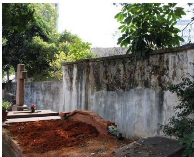
fig 181. Trecho da face interna do Muro voltado para a Rua Sergipe. Data: 22/05/2023.
