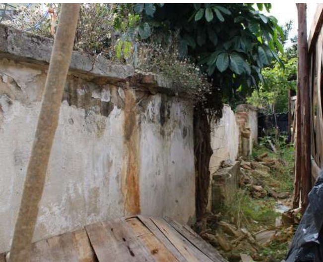
fig 171. Trecho da face interna do Muro voltado para a Rua Mato Grosso. Destaque para a presença de raízes (vegetação infestante). Data: 22/05/2023.
