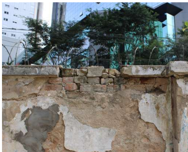
fig 230. Trecho com perda de elementos (tijolos) e risco de desprendimento / queda. Face externa. Data: 22/05/2023.
