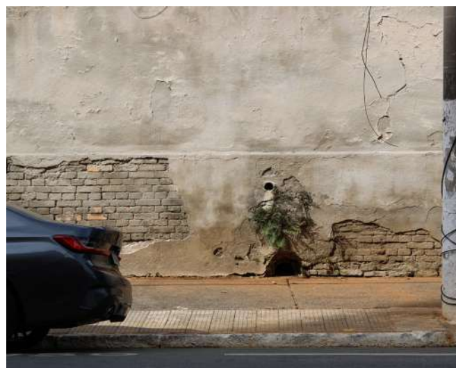
fig 226. Trecho do sócolo onde é possível observar a ação da umidade ascendente, inclusive com a presença de vegetação infestante. . Data: 22/05/2023.
