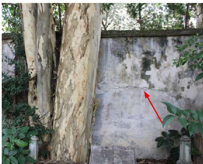
fig 255. Trincas horizontais ocasionadas pela árvore de grande porte encontrada junto ao muro. Data: 22/05/2023.
