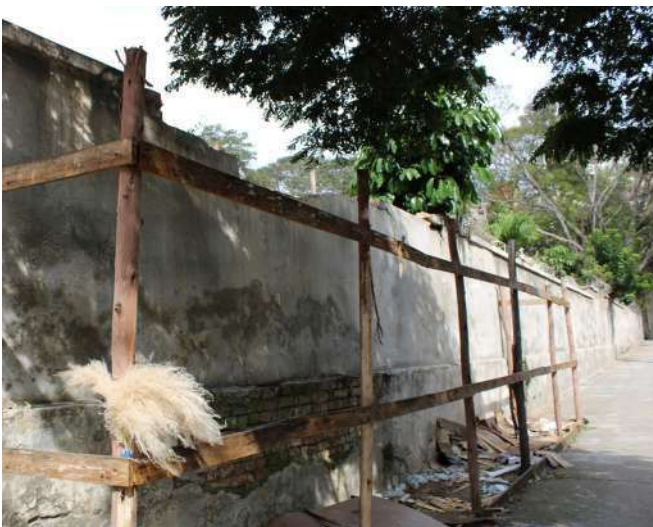
fig 159. Trecho da face externa do Muro voltado para a Rua Mato Grosso. Destaque para a estrutura de escoramento. Data: 22/05/2023.
