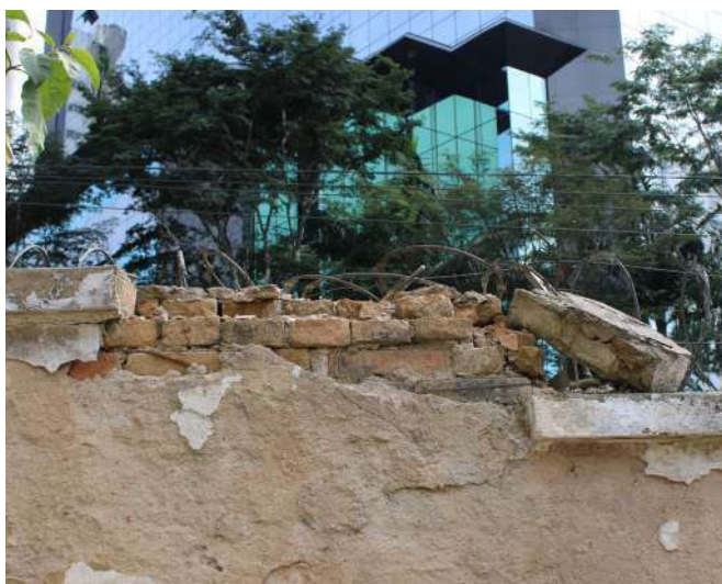
fig 231. Trecho com perda de elementos (tijolos) e risco de desprendimento / queda. Face externa. Data: 22/05/2023.
