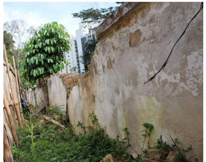
fig 172. Trecho da face interna do Muro voltado para a Rua Mato Grosso. Trata-se do mesmo trecho que se encontra escorado do lado externo. Data: 22/05/2023.
