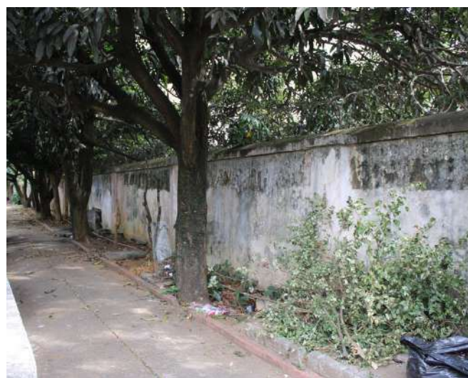
fig 176. Trecho da face interna do Muro voltado para a Rua Mato Grosso. Data: 22/05/2023.
