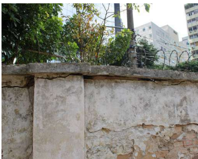
fig 233. Grande rachadura ocasionada pela presença de raízes, as quais provocam esforços sobre os muros. Data: 22/05/2023.
