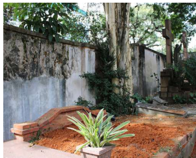
fig 180. Trecho da face interna do Muro voltado para a Rua Sergipe. Data: 22/05/2023.
