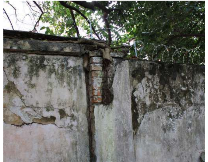
fig 252. Trecho com tijolos expostos devido à ação das raízes das vegetações infestantes. Data: 22/05/2023.
