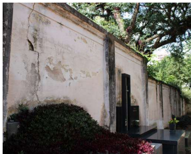
fig 198. Trecho da face interna do Muro voltado para a Rua Sergipe. Data: 22/05/2023.
