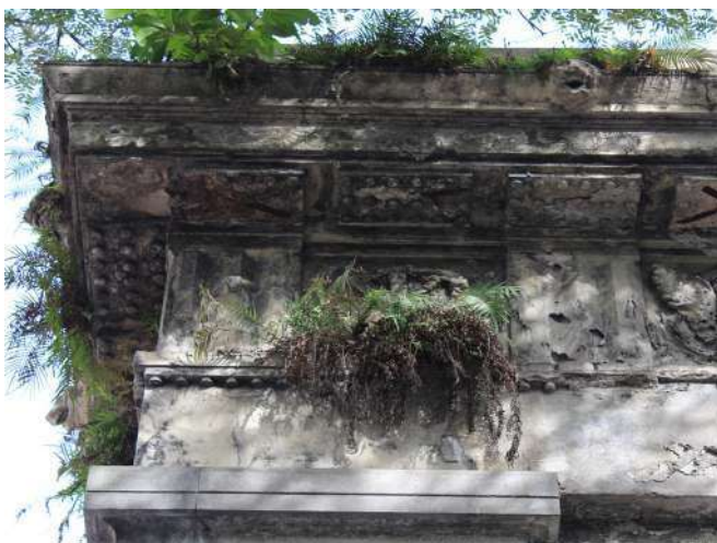
fig 35. Vegetação infestante encontrada no entablamento e cobertura do Pórtico Frontal. Data: 22/05/2023.
