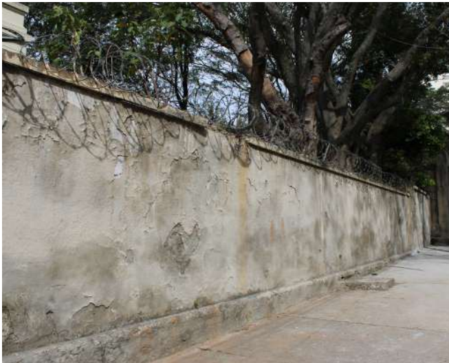
fig 157. Trecho da face externa do Muro voltado para a Rua Mato Grosso. Data: 22/05/2023.
