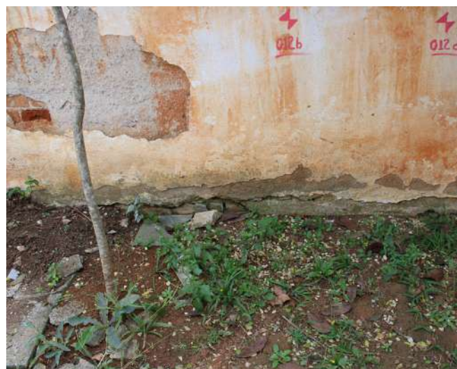
fig 242. Ação da umidade ascendente provocando o desprendimento das camadas de pintura e da argamassa da base. Data: 22/05/2023.
