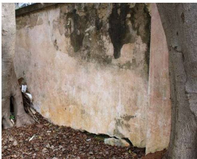
fig 229. Trecho com grande presença de colonizações biológicas e desprendimento de argamassa na base. Data: 22/05/2023.
