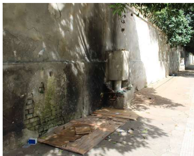
fig 164. Trecho da face externa do Muro voltado para a Rua Mato Grosso. Destaque para a má conservação da proteção das tubulações. Data: 22/05/2023.
