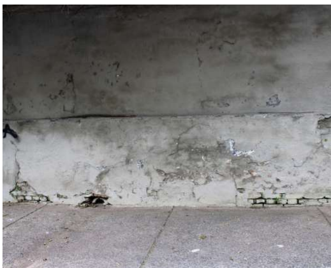
fig 223. Trecho do sócolo onde é possível observar a ação da umidade ascendente. Data: 22/05/2023.
