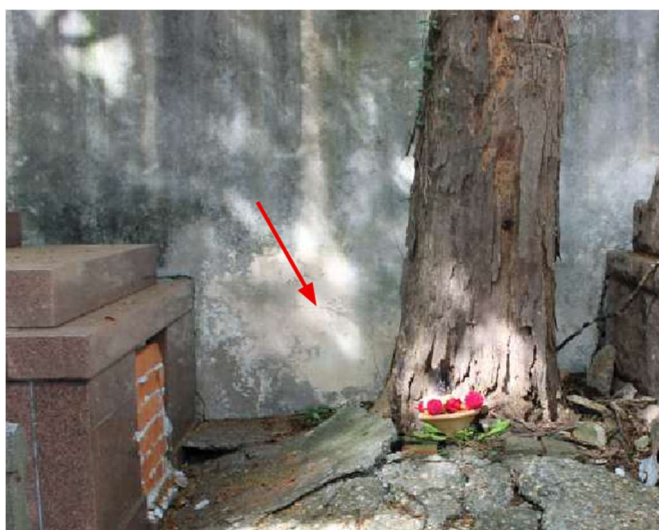
fig 257. Levantamento do piso provocado pelas raízes de uma das árvores. Nota-se também o aparecimento de fissuras na face interna do muro. Data: 22/05/2023.
