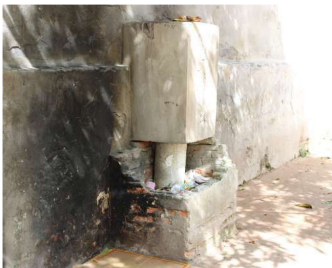
fig 225. Detalhe da estrutura de proteção das tubulações bastante danificada. Data: 22/05/2023.
