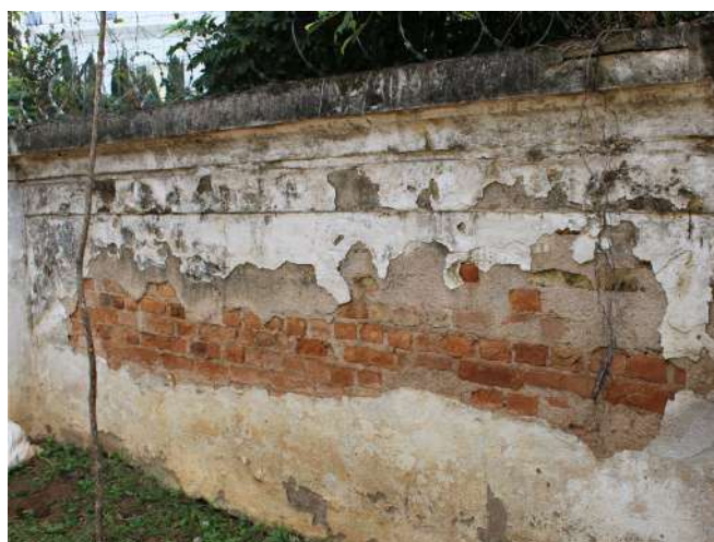
fig 20. Desprendimento de argamassa em trecho da face interna do Muro. Data: 22/05/2023.
