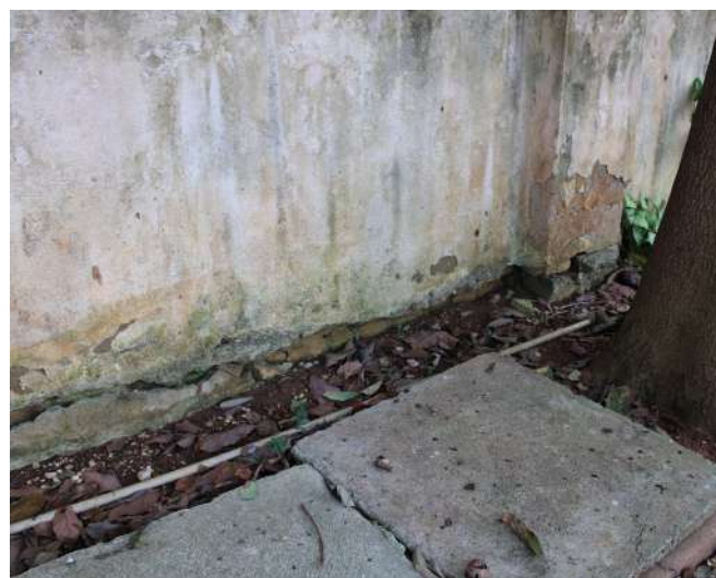
fig 246. Ação da umidade ascendente: desprendimento das camadas de pintura, da argamassa da base e presença de colonizações biológicas. Data: 22/05/2023.
