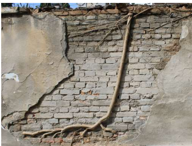
fig 37. Raízes encontradas em trecho da face externa do Muro. Data: 22/05/2023.
