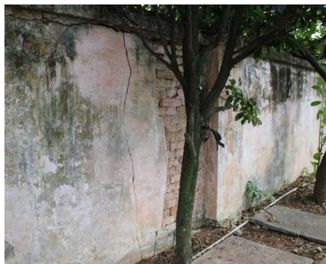
fig 248. Grande trinca vertical indicando o contínuo deslocamento da argamassa. Data: 22/05/2023.
