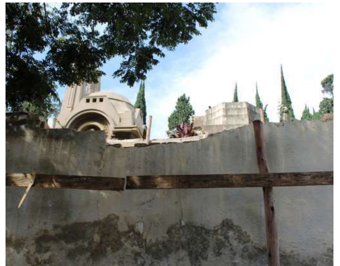
fig 218. Trecho com considerável perda de elementos (tijolos) e instabilidade estrutural. Data: 22/05/2023.
