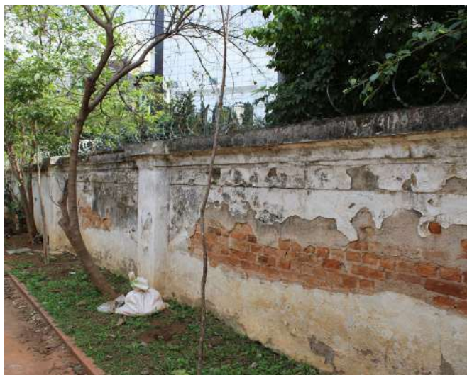
fig 173. Trecho da face interna do Muro voltado para a Rua Mato Grosso. Destaca-se o desprendimento dos revestimentos. Data: 22/05/2023.
