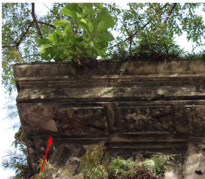
fig 13. Crosta negra identificada em trecho da lateral do entablamento do Pórtico Frontal. Data: 22/05/2023.
