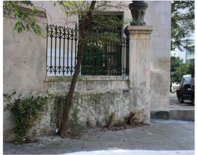
fig 83. Trecho da murada a frente da Lateral Esquerda do Pórtico Frontal. Data: 22/05/2023.
