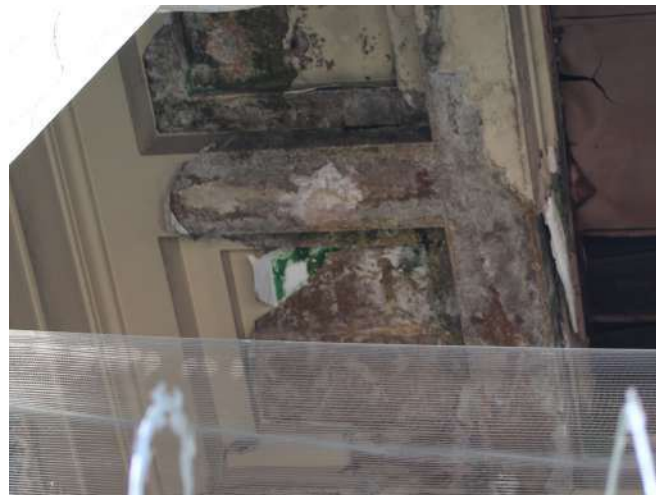
fig 22. Desprendimento das camadas de pintura no forro do Pórtico Frontal. Data: 22/05/2023.
