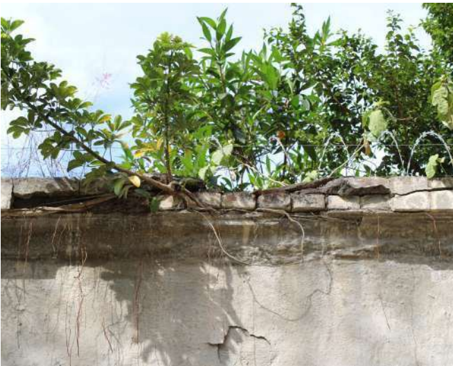
fig 221. Exemplo da ação da vegetação infestante onde as raízes provocam o desprendimento das argamassas e tijolos. Data: 22/05/2023.
