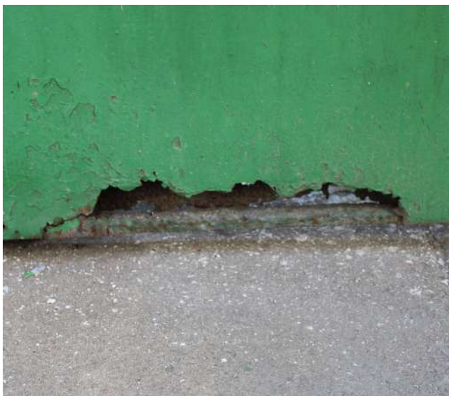
fig 11. Corrosão encontrada na base da folha do portão de ferro do Pórtico Frontal (face posterior). Data: 22/05/2023.
