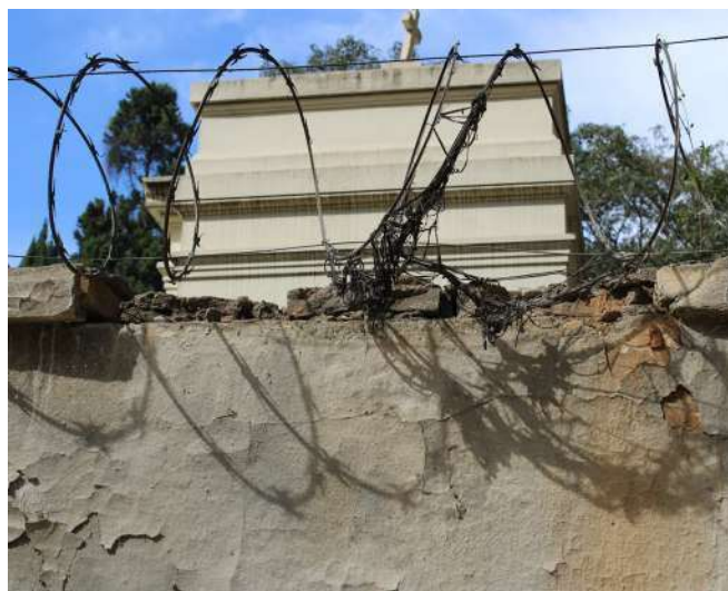
fig 214. Trecho com perda de elementos (tijolos) e risco de desprendimento / queda. Face externa. Data: 22/05/2023.
