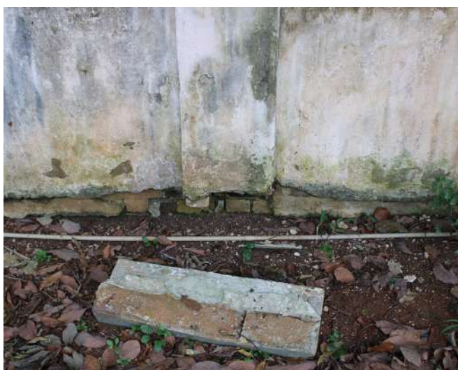
fig 245. Ação da umidade ascendente: desprendimento das camadas de pintura, da argamassa da base e presença de colonizações biológicas. Data: 22/05/2023.
