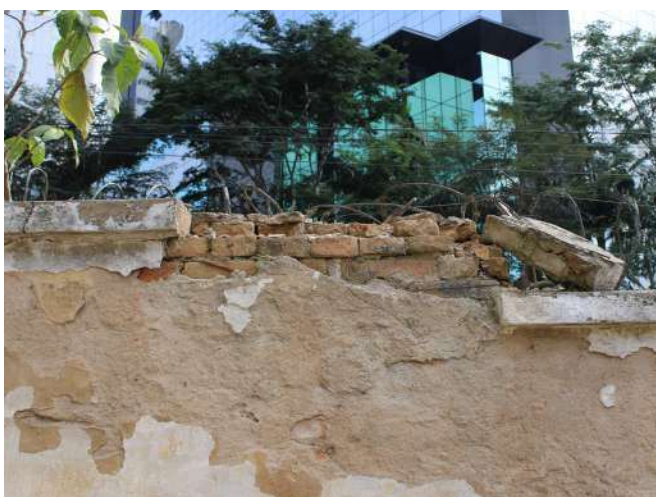
fig 19. Desprendimento de argamassa em trecho da face interna do Muro, já com perda do suporte. Data: 22/05/2023.
