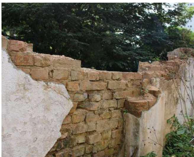
fig 239. Trecho com considerável perda de elementos (toda a argamassa e tijolos) e instabilidade estrutural. Data: 22/05/2023.
