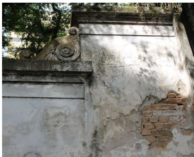
fig 270. Ação da umidade ascendente provocando o desprendimento das camadas de pintura e da argamassa. Data: 22/05/2023.
