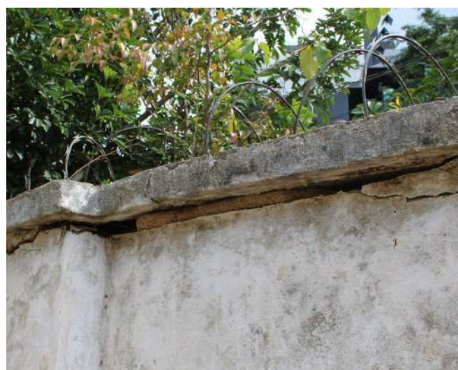
fig 234. Detalhe da raiz já provocando o desprendimento dos tijolos e conseqüente instabilidade estrutural. Data: 22/05/2023.
