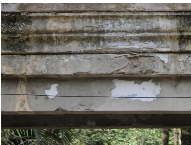
fig 23. Desprendimento das camadas de pintura no Pórtico Posterior. Data: 22/05/2023.
