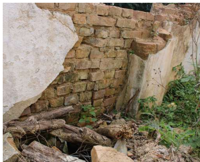
fig 240. Trecho com considerável perda de elementos (toda a argamassa e tijolos) e instabilidade estrutural. Data: 22/05/2023.
