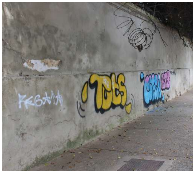
fig 32. Pichações em trecho da face externa do Muro. Data: 22/05/2023.
