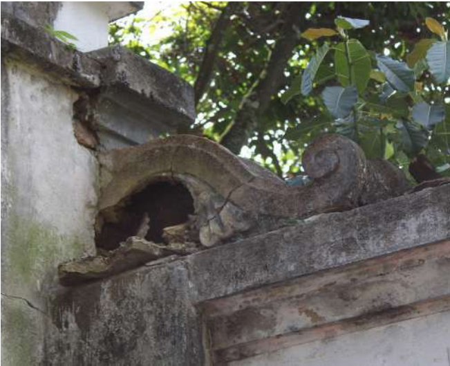
fig 263. Exemplo de um dos ornamentos em voluta, componentes dos muros, com quebra e risco de queda. Data: 22/05/2023.
