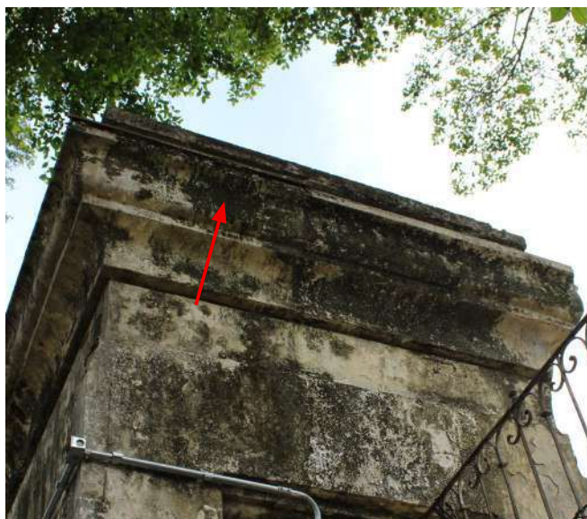
fig 14. Crosta negra identificada em trecho da lateral do entablamento do Pórtico Posterior. Data: 22/05/2023.
