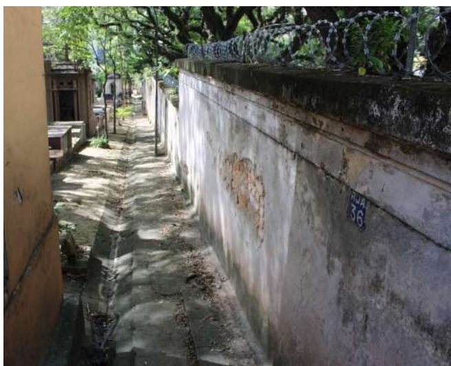
fig 209. Trecho da face interna do Muro voltado para a Rua da Consolação, na altura da escada. Data: 22/05/2023.
