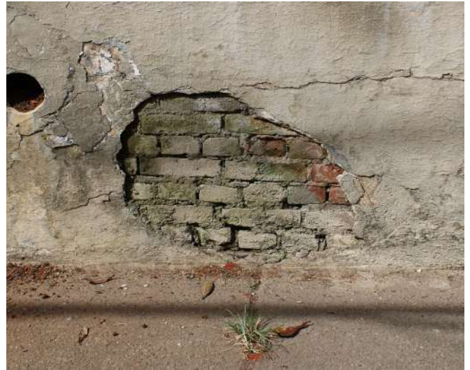
fig 220. Trecho com desprendimento de argamassa e consequente exposição dos tijolos. Data: 22/05/2023.
