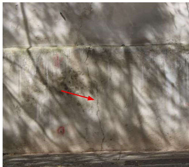
fig 28. Fissura vertical encontrada na face externa do Muro. Data: 22/05/2023.
