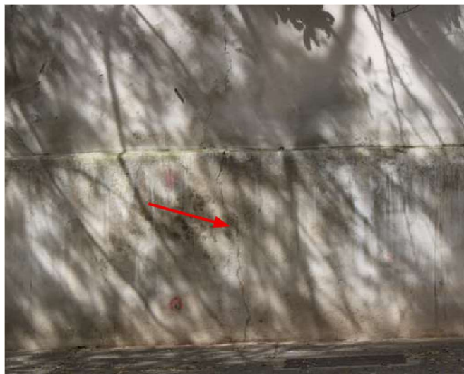
fig 228. Grande trinca vertical provocada pela árvore de grande porte que se encontra junto ao muro. Data: 22/05/2023.
