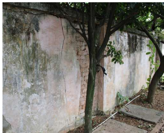
fig 178. Trecho da face interna do Muro voltado para a Rua Mato Grosso. Data: 22/05/2023.
