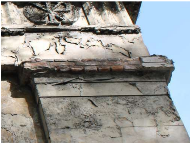
fig 15. Desprendimento de argamassa no capitel de uma das colunas do Pórtico Frontal. Data: 22/05/2023.
