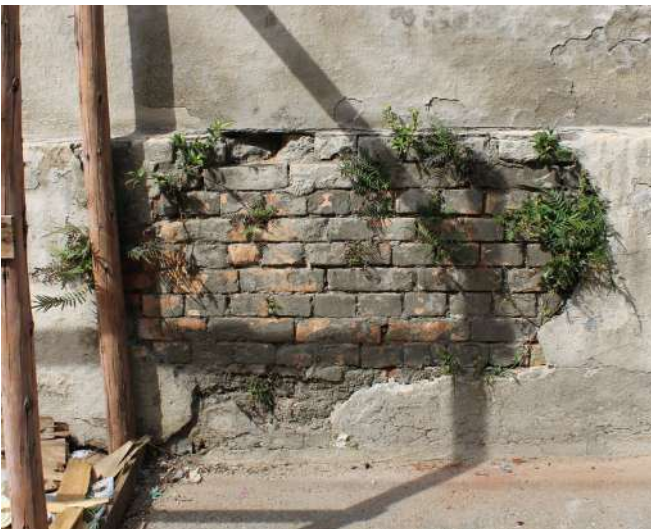
fig 217. Exemplo de vegetação infestante de menor porte em trecho com desprendimento de argamassa. Data: 22/05/2023.
