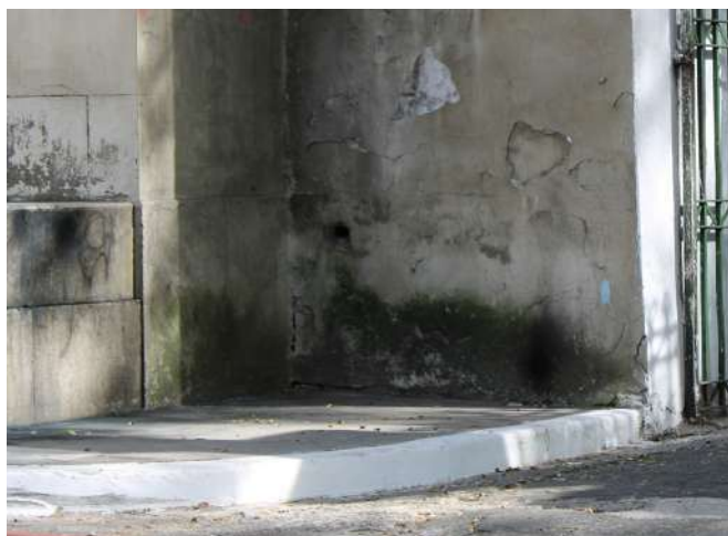
fig 5. Colonização biológica encontrada na base do Pórtico Frontal. Data: 22/05/2023.
