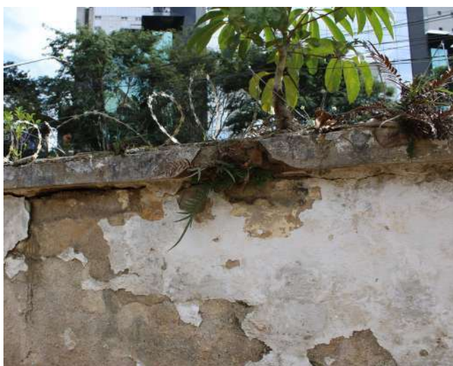
fig 237. Exemplo de vegetação infestante de menor porte já provocando o desprendimento de argamassa. Data: 22/05/2023.
