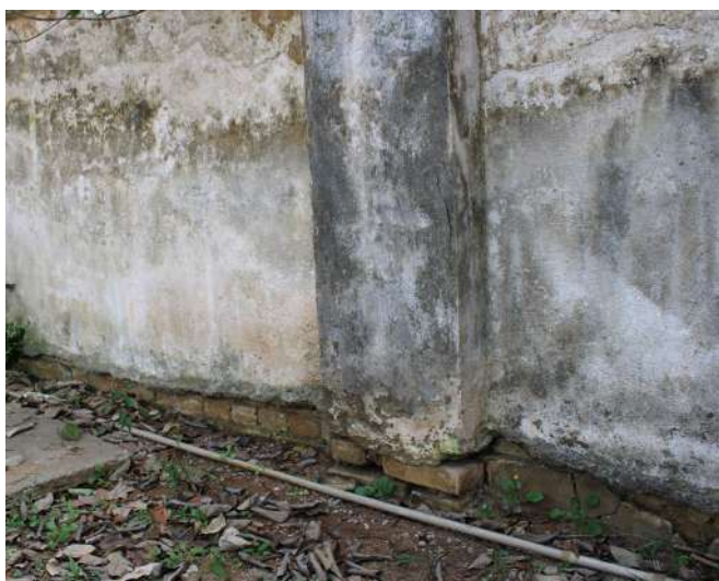
fig 247. Trecho com grande presença de colonizações biológicas e desprendimento de argamassa na base. Data: 22/05/2023.
