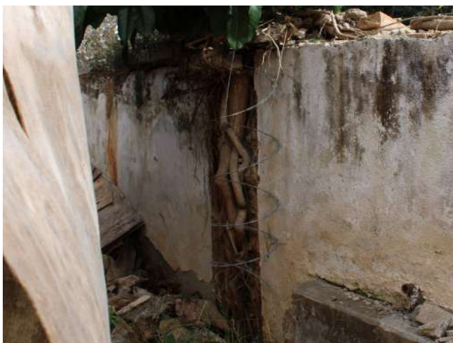
fig 39. Raízes de grande porte encontradas em trecho da face interna do Muro. Data: 22/05/2023.
