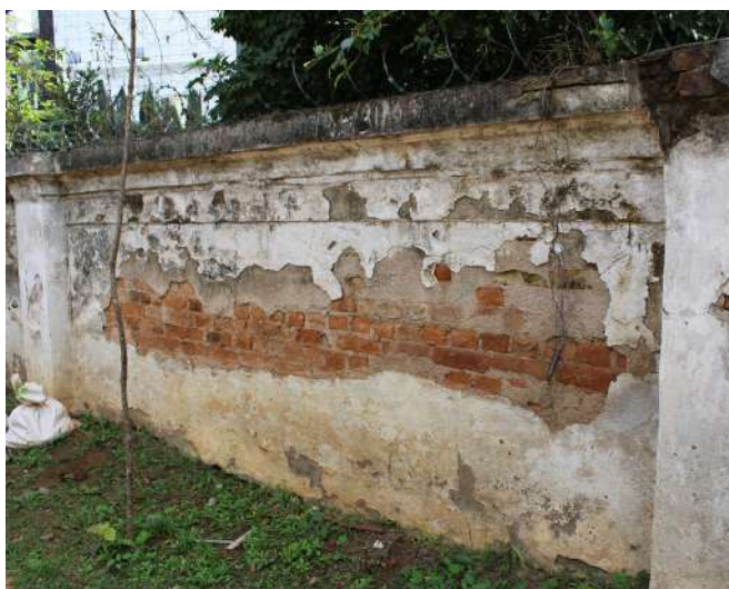
fig 241. Trecho com desprendimento de argamassa e consequente exposição dos tijolos. Nota-se a ação da umidade. Data: 22/05/2023.
