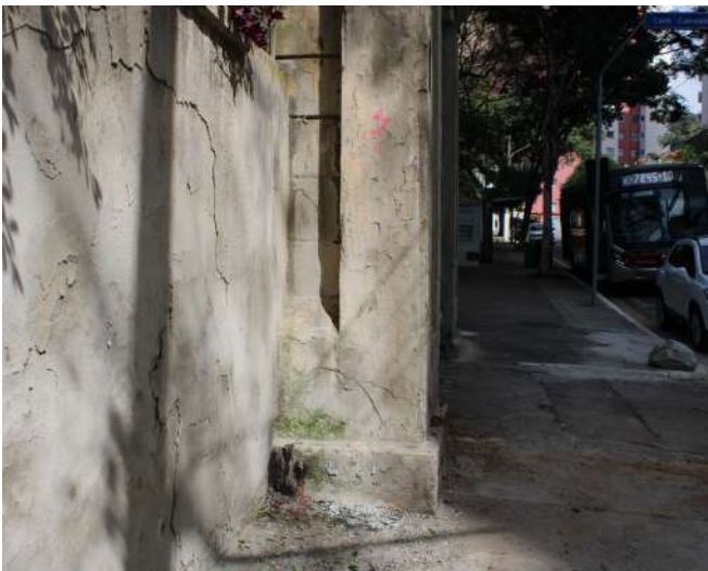
fig 146. Detalhe do trecho inferior da coluna esquerda do Pórtico Posterior, Vista Lateral Esquerda. Data: 22/05/2023.
