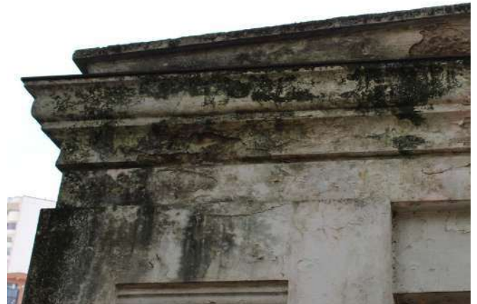
fig 8. Colonização biológica encontrada no entablamento do Pórtico Posterior. Data: 22/05/2023.
