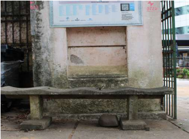
fig 7. Colonização biológica encontrada na base do Pórtico Posterior. Data: 22/05/2023.
