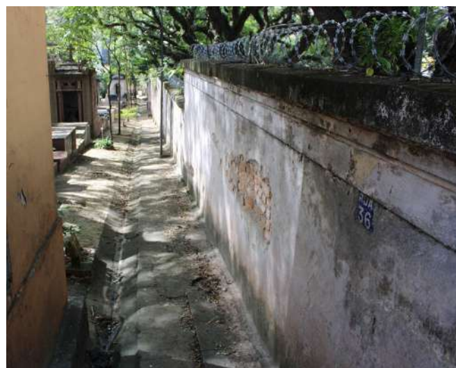
fig 212. Trecho da face interna do Muro voltado para a Rua da Consolação, na altura da escada. Data: 22/05/2023.
