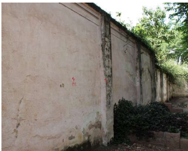
fig 199. Trecho da face interna do Muro voltado para a Rua Sergipe. Data: 22/05/2023.
