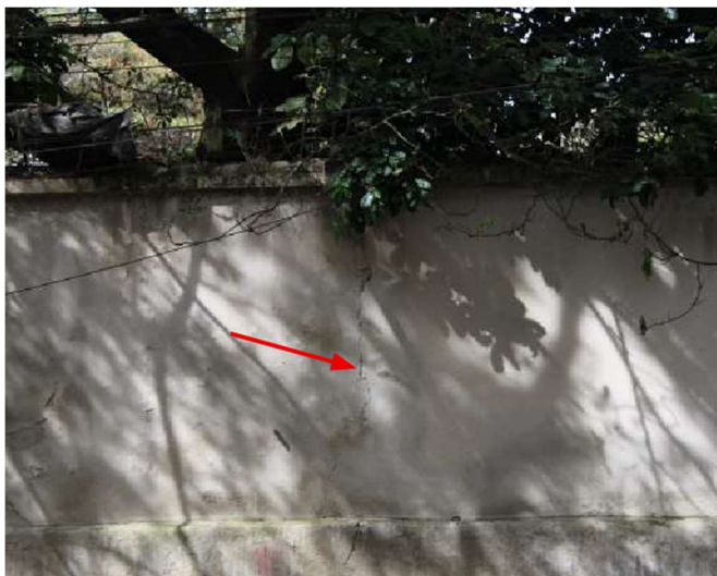
fig 227. Grande trinca vertical provocada pela árvore de grande porte que se encontra junto ao muro. Data: 22/05/2023.
