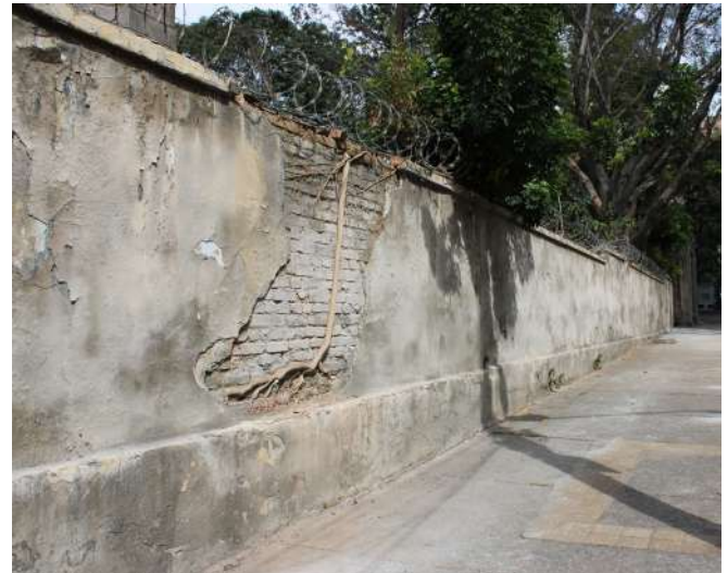
fig 158. Trecho da face externa do Muro voltado para a Rua Mato Grosso. Destaque para a presença de raízes (vegetação infestante). Data: 22/05/2023.
