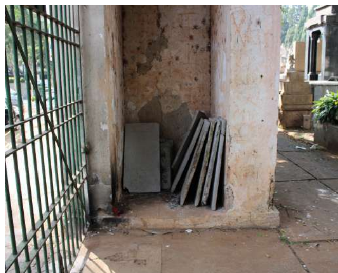
fig 153. Faces internas das colunas que estruturam o Pórtico Posterior, com destaque para os materiais depositados inadequadamente. Data: 22/05/2023.
