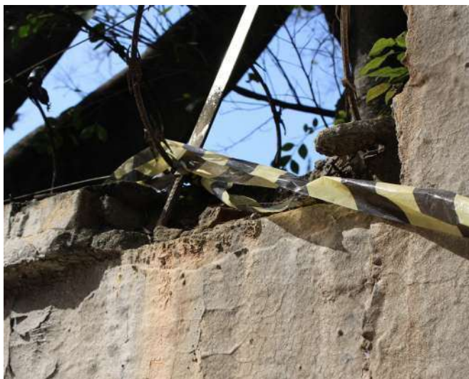
fig 213. Trecho com perda de elementos (tijolos) e risco de desprendimento / queda. Face externa. Data: 22/05/2023.
