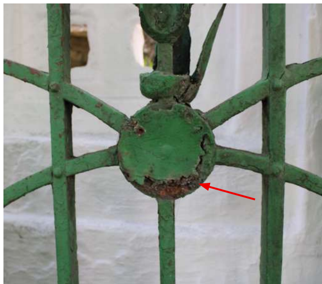
fig 12. Corrosão encontrada em um dos elementos de ferro componentes do portão do Pórtico Frontal (face posterior). Data: 22/05/2023.
