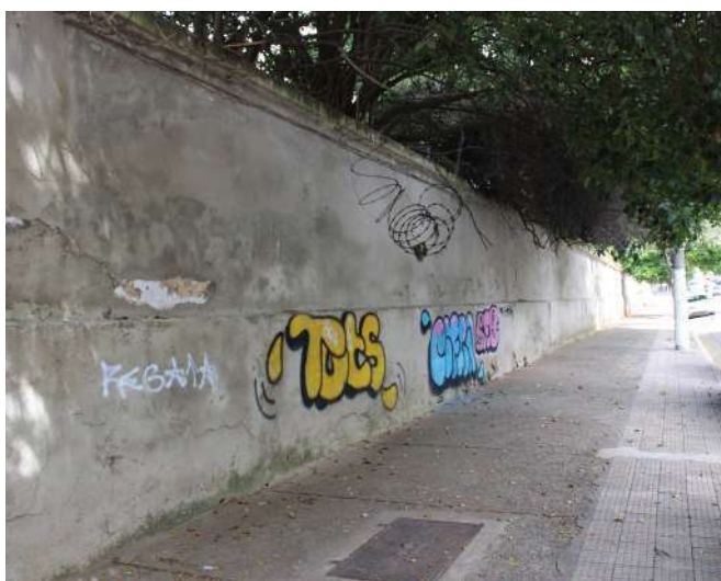
fig 163. Trecho da face externa do Muro voltado para a Rua Mato Grosso com pichações. Data: 22/05/2023.
