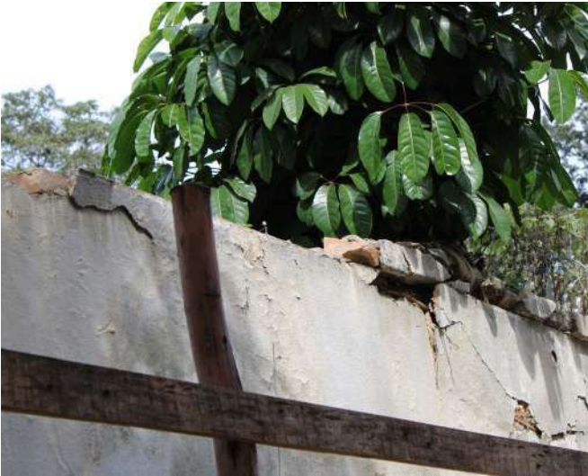
fig 219. Trecho com perda de elementos (tijolos) e risco de desprendimento / queda. Face externa. Data: 22/05/2023.
