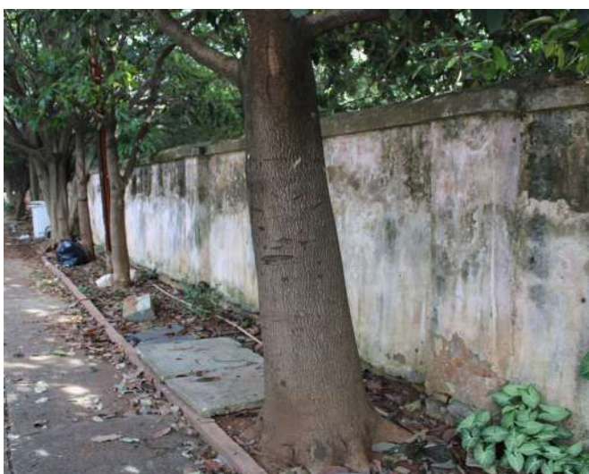
fig 175. Trecho da face interna do Muro voltado para a Rua Mato Grosso. Data: 22/05/2023.
