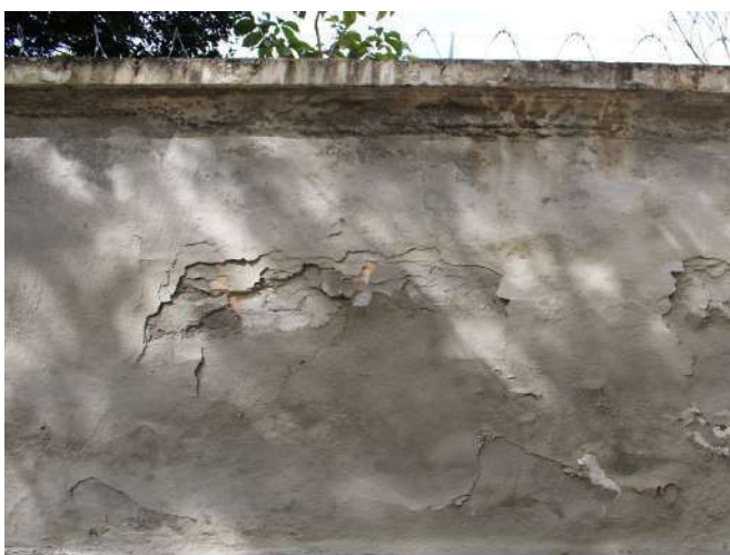
fig 25. Trecho com desprendimento das camadas de pintura na face externa do Muro. Data: 22/05/2023.
