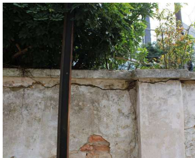
fig 232. Grande rachadura ocasionada pela presença de raízes, as quais provocam esforços sobre os muros. Data: 22/05/2023.
